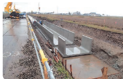
皆瀬4号幹線用水路
